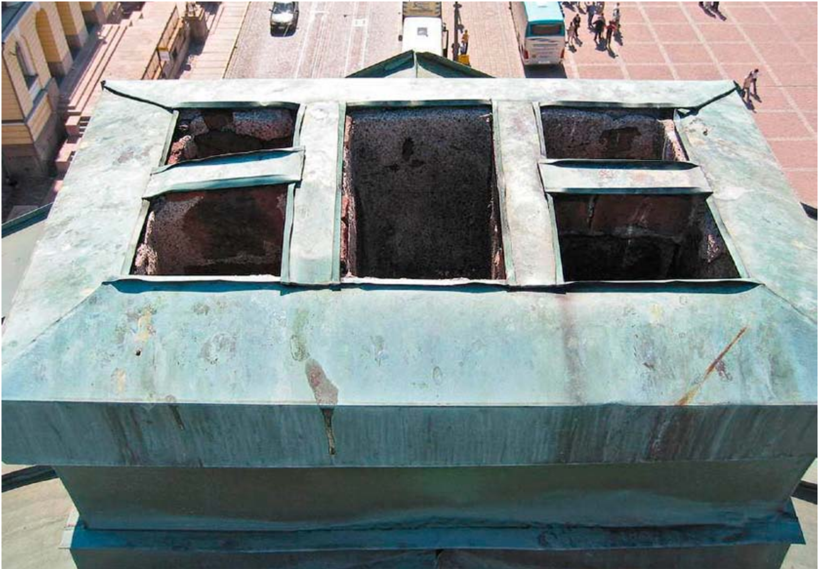
Helsingin tuomiokirkon Itäisen kappelin painovoimaisen ilmanvaihdon piippu ja hormit ovat edelleen painovoimaisen ilmanvaihdon käytössä.
