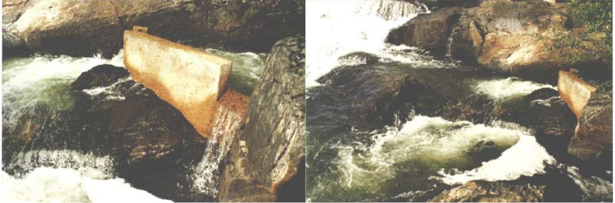
Valokuvat 17 ja 18. Kalaportaan alimman altaan sis antuloaukko 24.9.1997 ennen korjausta. Valokuvat Kjell Moen.
