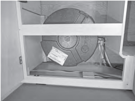
Boileri ja tyhjennysventtiili
